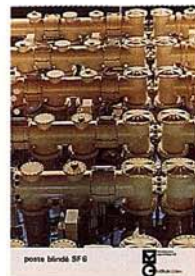
Matériel au SF 6 en cours d'essai au laboratoire Très Haute Tension (à gauche) et installé en poste (ci-dessus).
