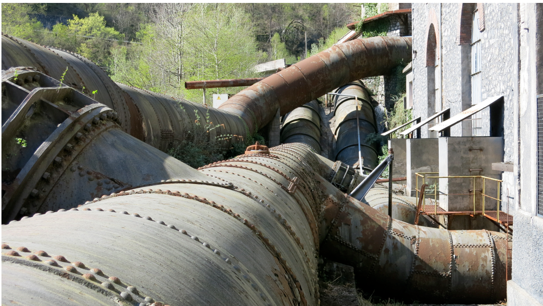
Fig. 71 - Le collecteur à l'arrivée des deux nouvelles conduites à la centrale - 1913
